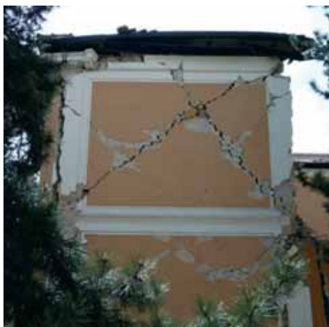
Fig. 5 - Danni ad edifici in muratura (L'Aquila)
