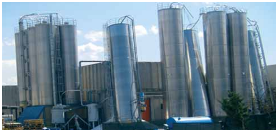
Fig. 8 - Danni a silos in acciaio, Bazzano (L'Aquila)
