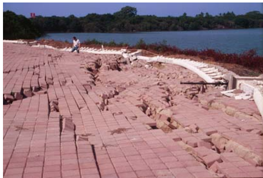
Deformazioni laterali dovuti a liquefazione nel porto di Manzanillo
