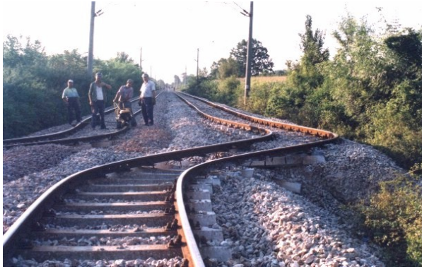
Terremoto di Izmit (Turchia, 1999): spostamento della linea ferroviaria per effetto della rottura in superficie
